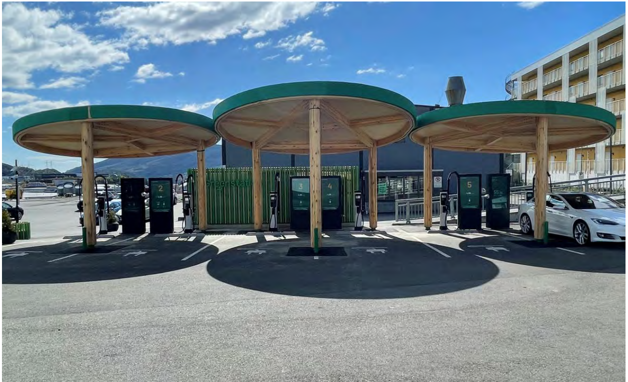
Пилотная «зеленая станция» Greenstation в Страуме (Норвегия)
